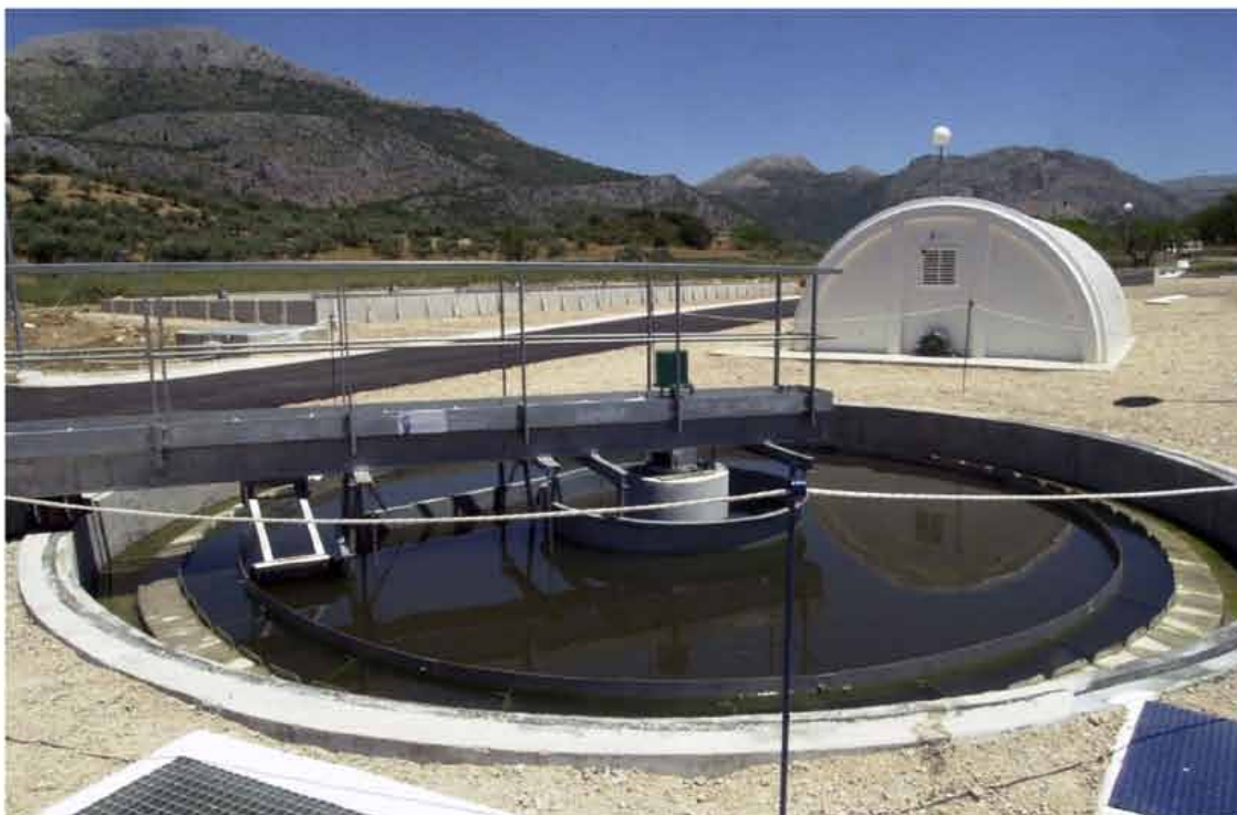
Imagen de una Estación Depuradora de Aguas Residuales (EDAR)
